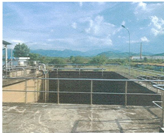
Hình 7. Bể gom, bể điều hòa
